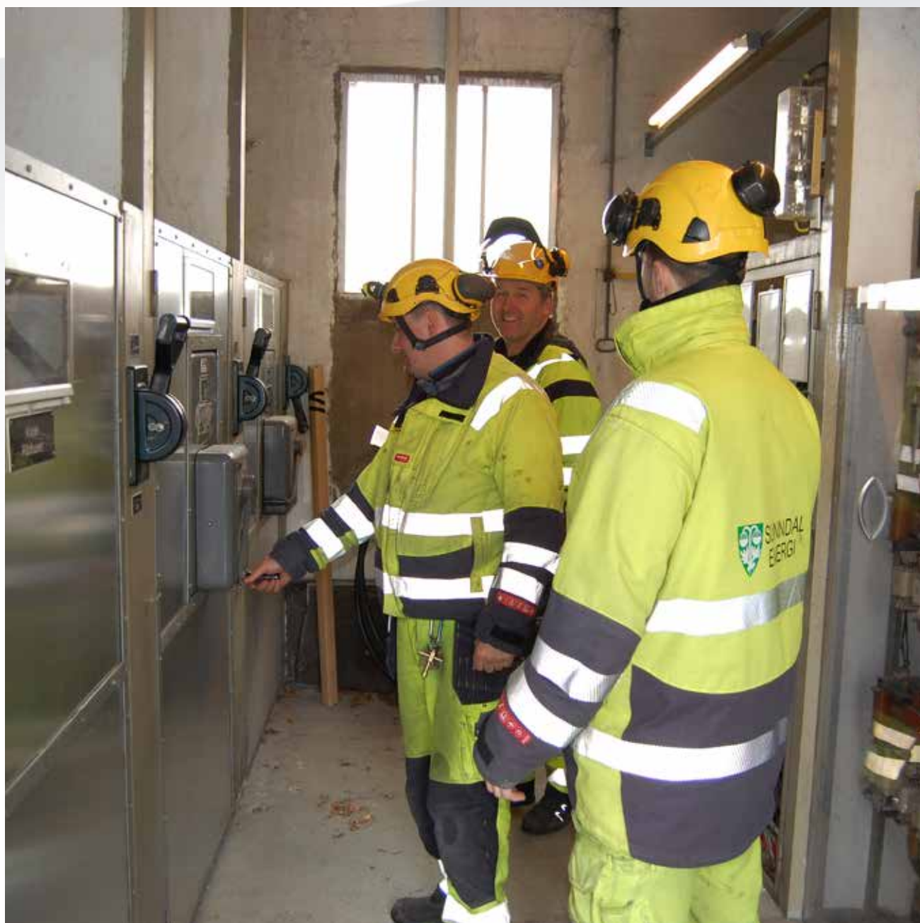
Nettstasjon Murgårdene. Foto A. Nedal
