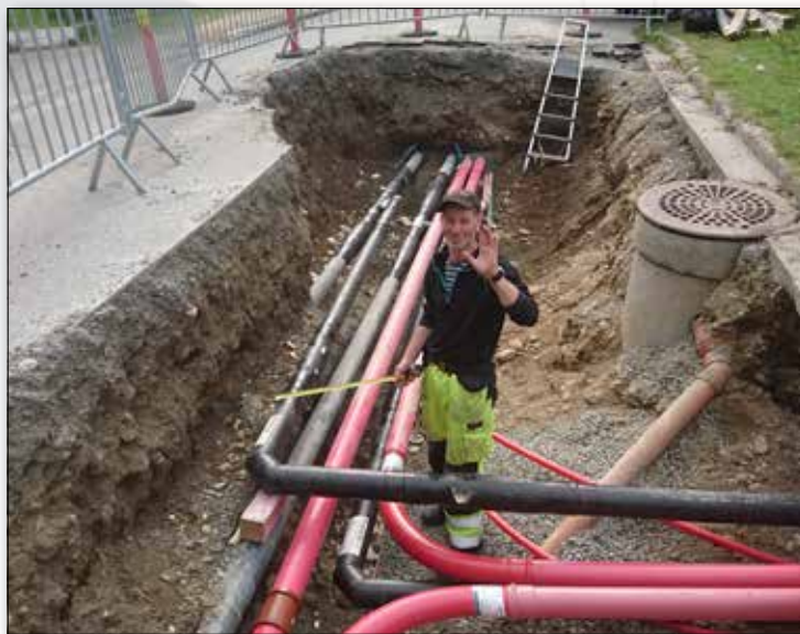
Fjernvarme i Lykkjevegen. Foto A. Nedal
